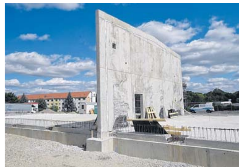
Diese Betonwand soll dem Brandschutz in der Garage des neuen Bauhofes dienen. Bevor das Gebäude überhaupt fertig ist, muss die Mauer wegen mehrerer schadhafter Stellen bereits saniert werden.
