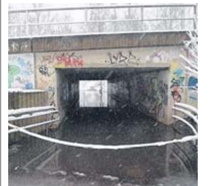
Erneut steht das Wasser in dem Fußgängertunnel. Er bleibt daher vorläufig gesperrt.
