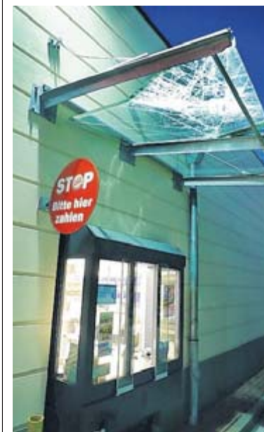
Das Vordach des Drive-In-Verkaufschalters von Burger King am Südring ist gesplittert. Ein Kleinlastwagen mit hohem Kastenaufbau war dagegen gefahren. FOTO: HARRY HÄRTTEL
