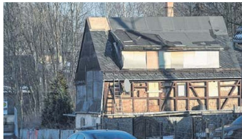
Bei der Sanierung des sogenannten Kanonenkugelhauses Frankenberger Straße 156 gibt es laut Stadtverwaltung kleine Fortschritte. FOTO: ANDREAS SEIDEL
